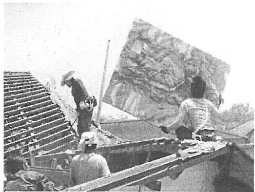
御船町にある故 田中憲一氏の 全壊したアトリエから作品を救出
